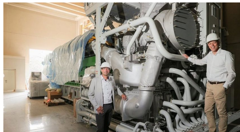
Technik-Geschäftsführer Michael Berger (rechts) und Vertriebsleiter Sebastian Pongratz von der Fernwärme Ulm vor dem neuen Jenbacher J920 Flextra
